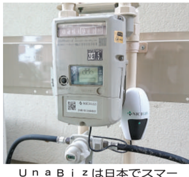
UnaBizは日本でスマートメーターを展開している
